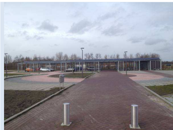
Pergola met zonnepanelen
